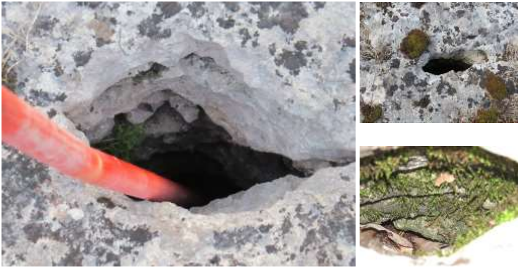
Figur 20. T.v. ett mindre slukhål (17 cm) på en till synes osprucken håll. Notera "mikrokarsten" i form av små skälliknande strukturer på väggarna, vilket visar att denna kavitet bildats/vidgats genom kemisk vittring och vattendränage. Inne i slukhålet finns en ca 2 meter djup dold karstspricka orienterad NO-SV. Överst t.h. ett annat slukhål (19 cm) som sträcker sig som ett rör ca 1 m ned innan horisontella uppspruckna lager tar över. Nederst t.h. visar botten av samma slukhål. Både slukhål och sprickor har ofta en särpräglad och fuktighetsgynnad flora och fauna. Alla tre foton från södra delen av Bunge Ducker 1:64. © Krister Mild
