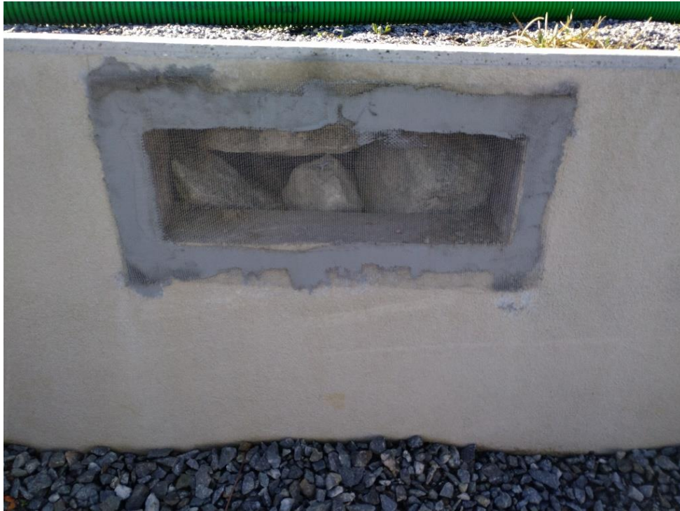
Figur 13 Utlopp bräddning R1 med nät och stenkross.
