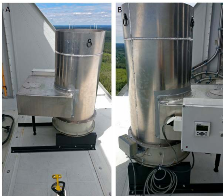
Figur 7. Insektsfällan på plats uppe på nacellen framför kylflänsarna. (A) Fällan från sidan med stödben under revolvermagasinet. (B) Fällan från andra sidan med kontrollpanelen synlig.
