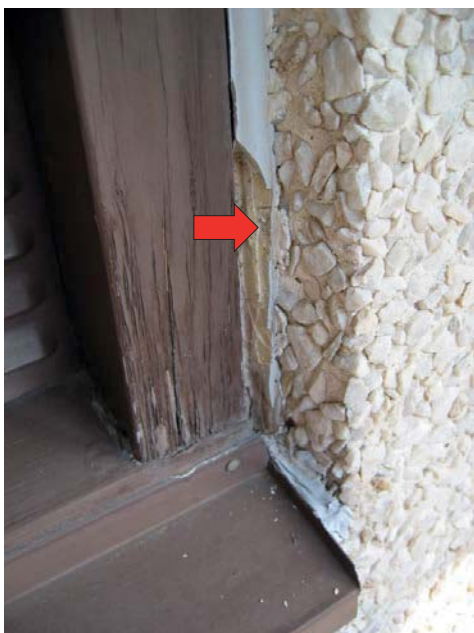
Fogmassa vid fönster
