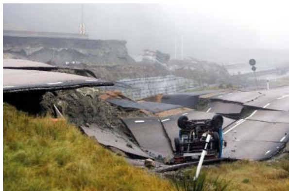
E6 i Bohuslän efter jordskredet 2006.
