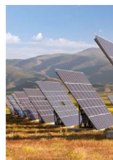
Solcellsanläggning i Spanien (s. 166).
