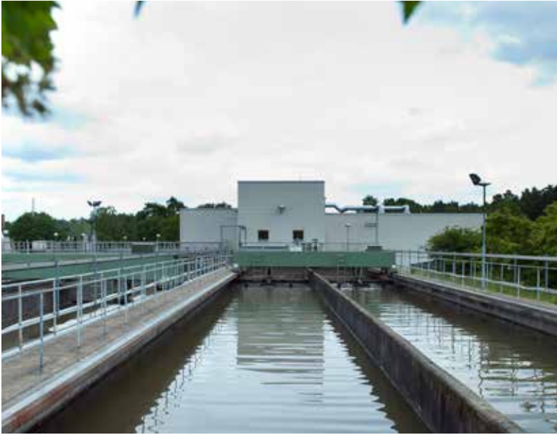
Vid Gässlösa reningsverk var halterna av PFAS höga både i in- och utgående vatten och dessutom högre i det utgående, reade vattnet.
