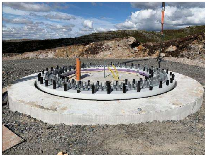
Figur 3-2: Turbinfundament og tårn i Tonstad vindkraftverk etter tilbakefylling av masse. Mest sannsynlig vil det bli valgt samme type fundamentering på Aremark. (Foto: Tonstad Vindpark AS)
